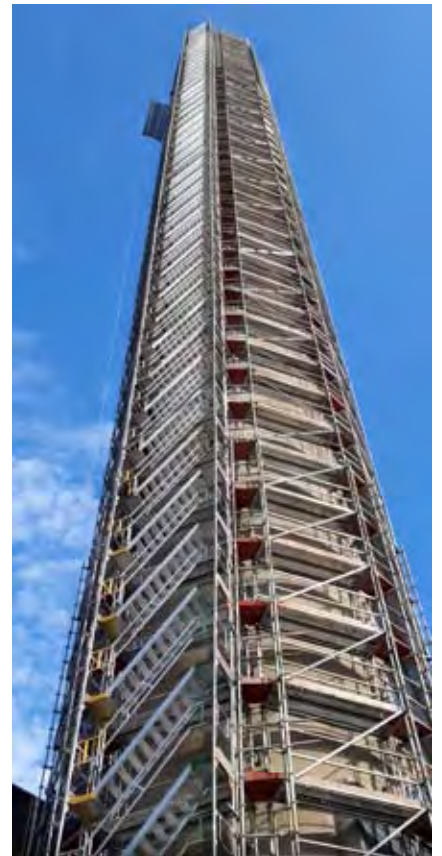
Tämä pölytön puhalluskohde lienee korkein Suomessa mitä on tehty. Kohteella korkeutta 100 m. Puhallusrakeena Testra 0,1 - 0,5 mm. Raetta kului n. 3 kg / m 2 . Puhallusletkua 120 m. Ilman lähde 8 m 3 / min. / 9,5 bar.
