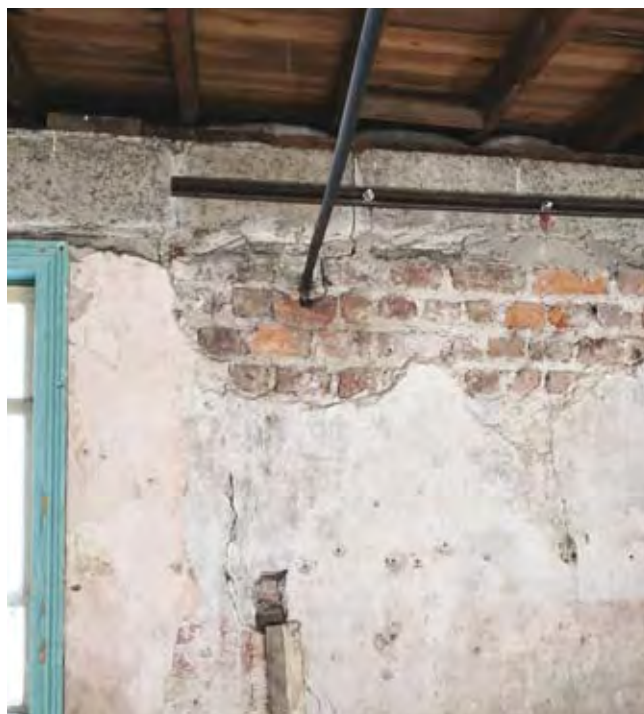
Seinissä näkyvät vuosisatojen korjausten, purkujen ja muutosten jäljet. Ns. alkuperäistä on näissä kohteissa aina vaikea määrittellä.
