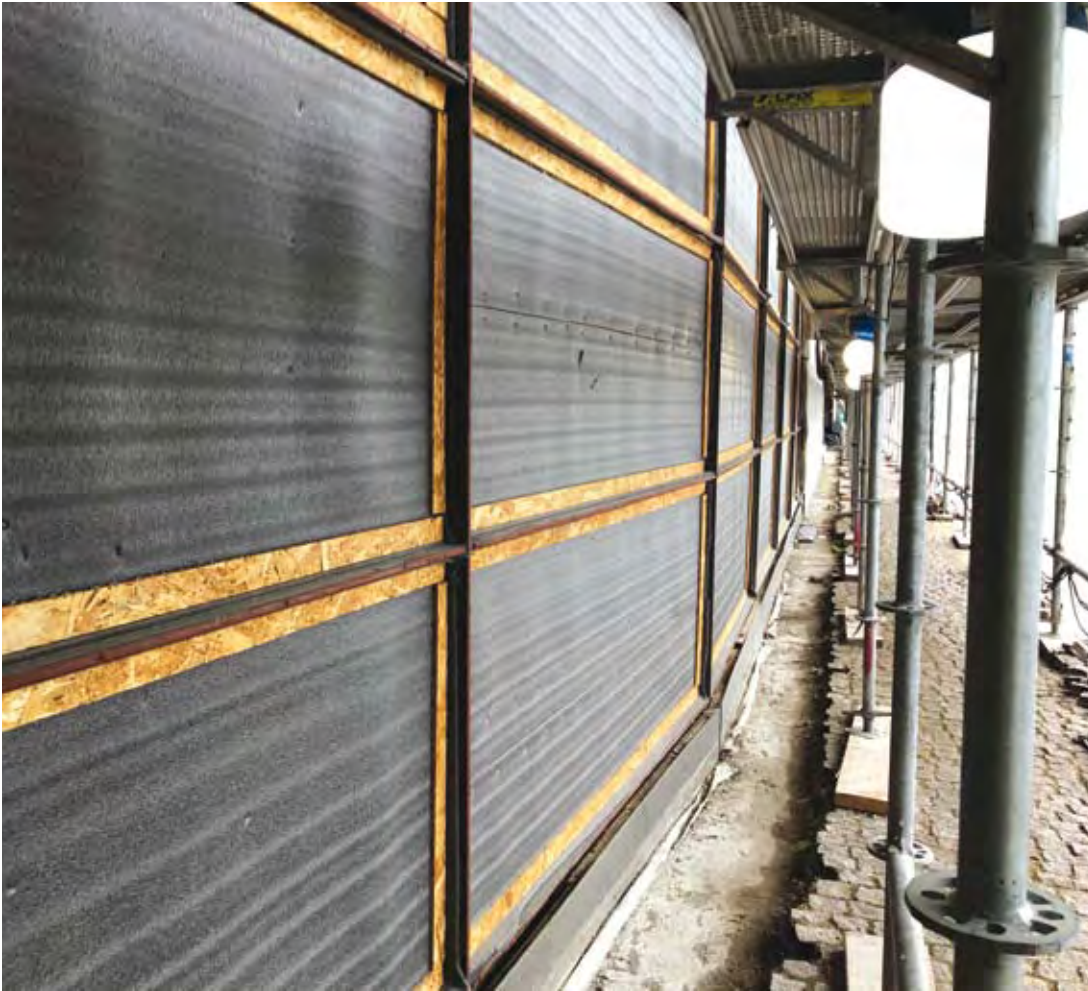
Lasien paino on ollut liikaa näitä kantavalle profiilille. Runko on käyrästynyt ja ruudut painuneet paikoin tiukasti kiinni toisiinsa. Tämä on johtanut vesivuotoihin sekä lasien hajoiluun.
