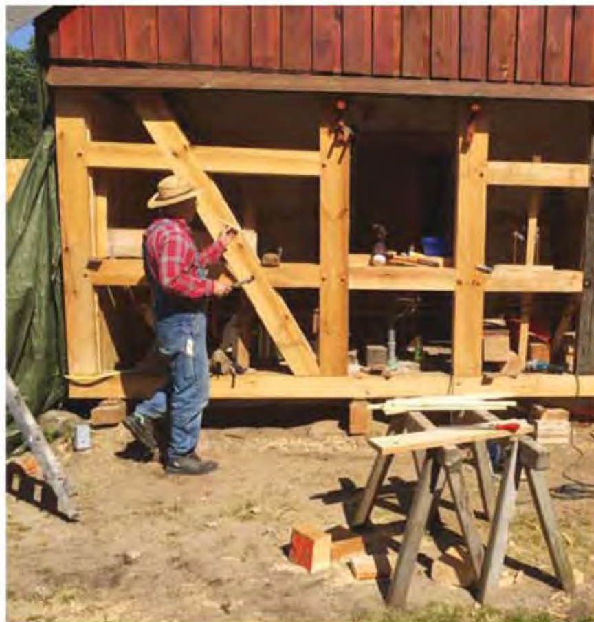
Edingerien talo oli niin huonossa kunnossa, että se piti purkaa lähes kokonaan. Rappauksen alta paljastui mädäntynyt puukehikko ja vanhentuneet tiilet. Kun kivijalka oli uusittu, kirvesmies Wulff rakensi uuden kehikon ja uudet tiilet muurattiin kehikkoon. Kuvat Hans Richard Edinger
