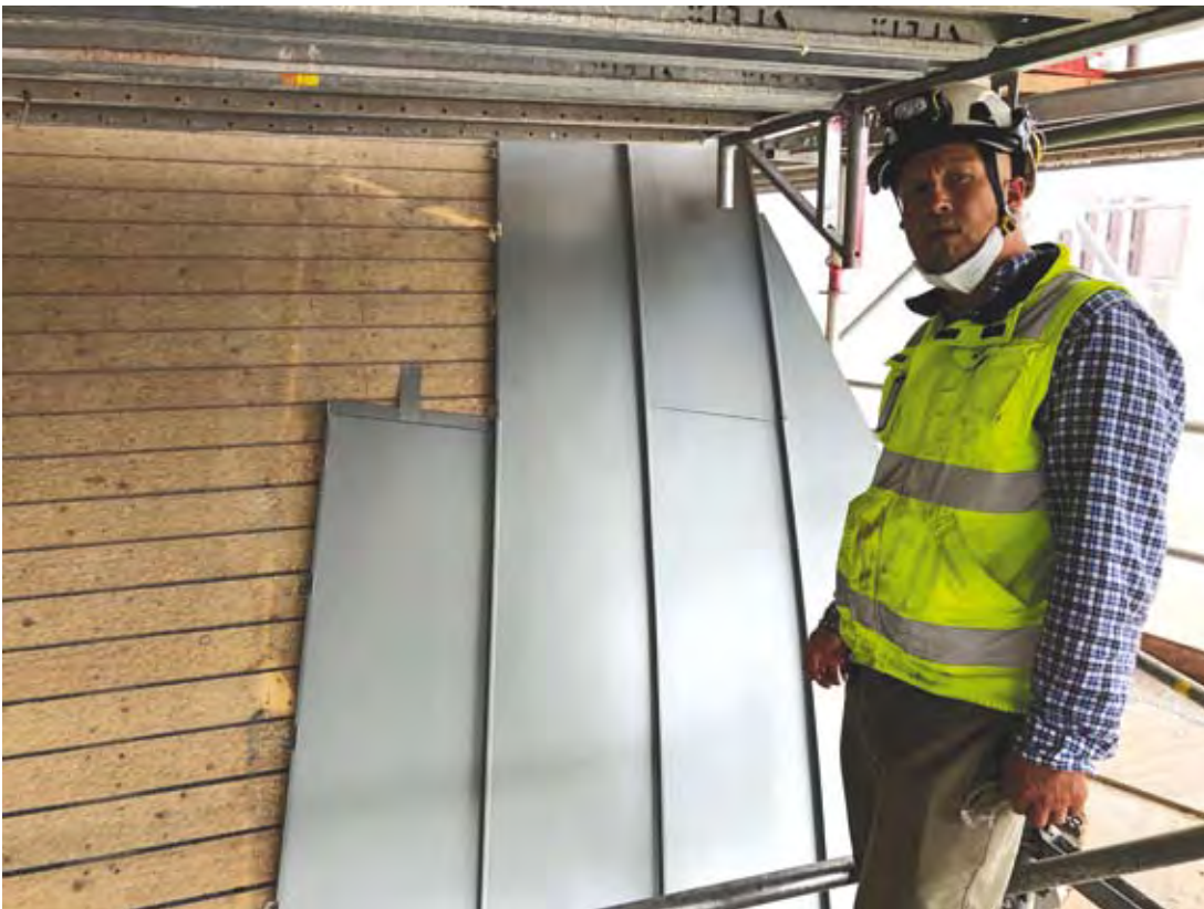
Sinkkipelti on kestänyt materiaalina Nickin mukaan Kiasman katossa varsin hyvin. Vuodot menivät kuitenkin vaihtoon koska saumojen auki leikkaaminen kavensi kappaleita. Sinkkipellin saumauksessa ei saa tehdä teräviä kääntöjä, pellin toimittaja kurssitti samalla asentajat.
